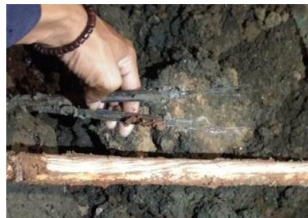
Gambar 16 . Dokumentasi Putus Kabel Optik
