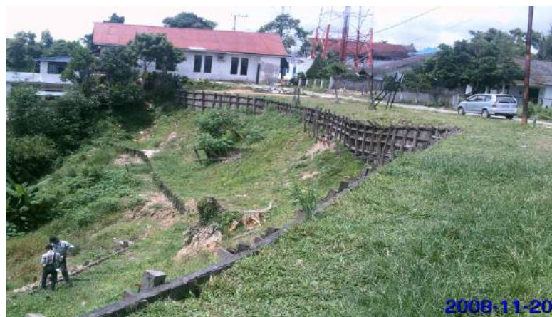
Gambar 10 Foto longsor lokasi LP-28, perhatikan penahan dari kayu yang melengkung. Pada bagian bawah lokasi terdapat rembesan air.
