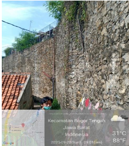
Gambar 5. Tembok Penahan Tanah Kondisi Tegak di belakang Café The Orange
